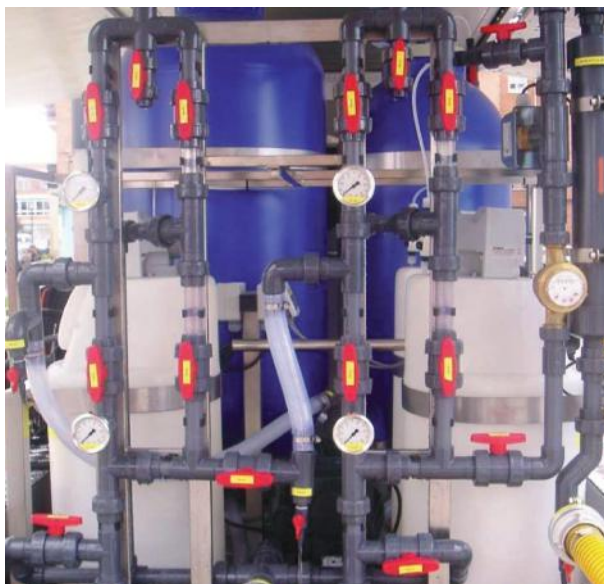
Figura 30: Posición válvulas: Vaciado de transporte y almacenaje.
