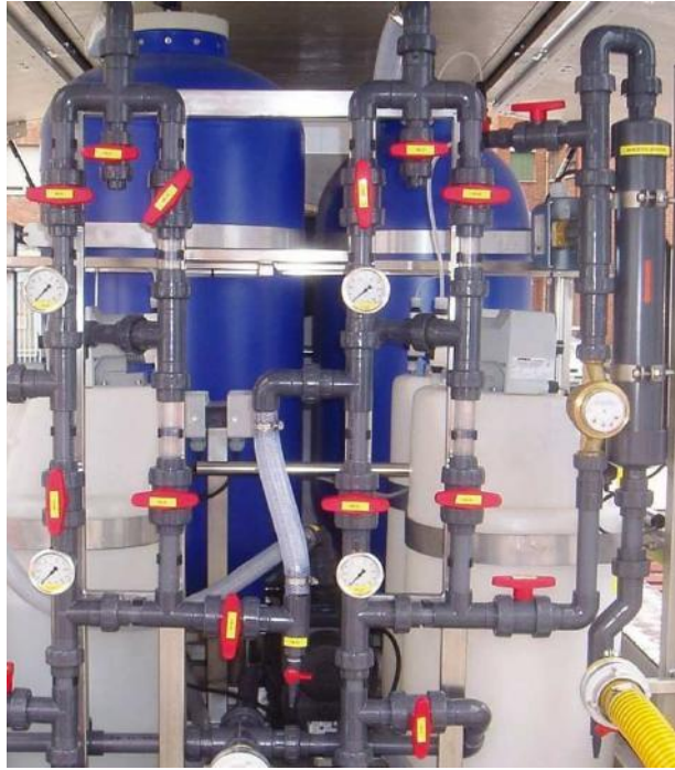
Figura 26: Posición válvulas: Contralavado del filtro de arena (Silex)
