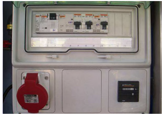
Figura 21: Panel eléctrico de control
