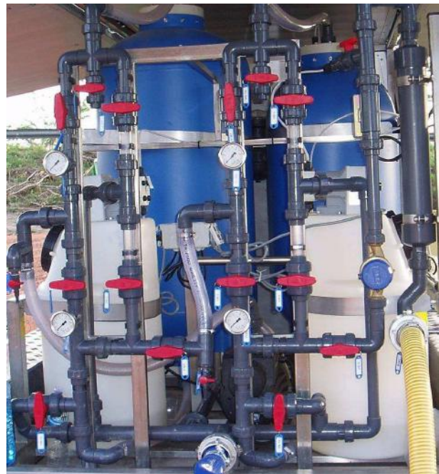
Figura 25: Posición valvulería: Funcionamiento en potabilización
