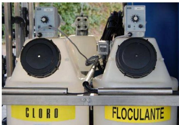
Figura 23: Controladores de bomba de dosificación
