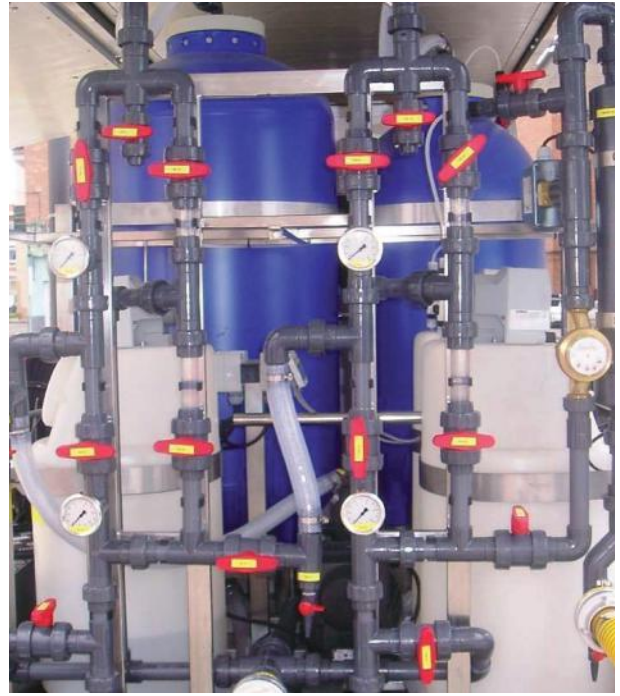
Figura 29: Posición válvulas: lavado del filtro de Carbón Activo.
