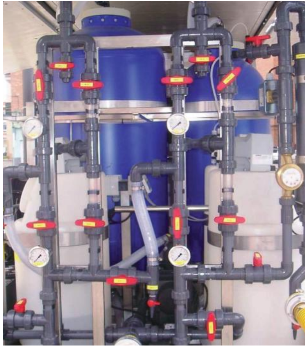
Figura 28: Posición válvulas: Contralavado del filtro de Carbón Activo.
